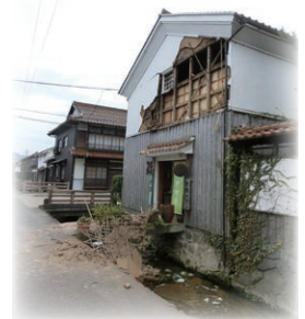
地震により崩壊した白壁土蔵(赤瓦3号館) (写真提供:鳥取県)
