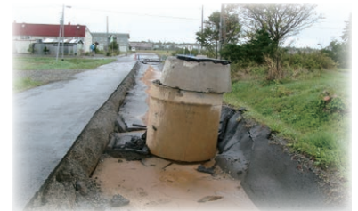
地震により浮き上がったマンホール (写真提供:小野 教授)
