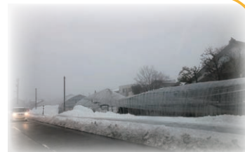
富山市内にある ビニールハウスの倒壊 (写真提供: 杉浦教授)
